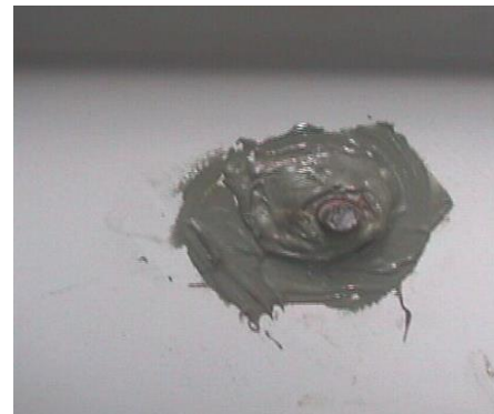
La masilla que no es de fábrica mantiene los pernos en su lugar.
