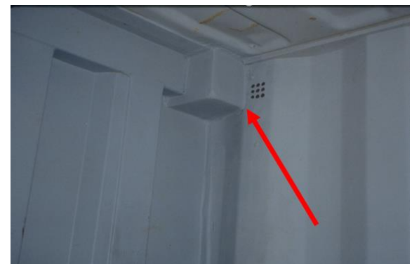
Corta distancia entre bloque y ventilación. Los colores de las paredes son diferentes.
