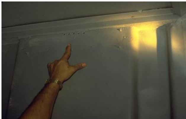
Una fila de orificios de ventilación visibles.
