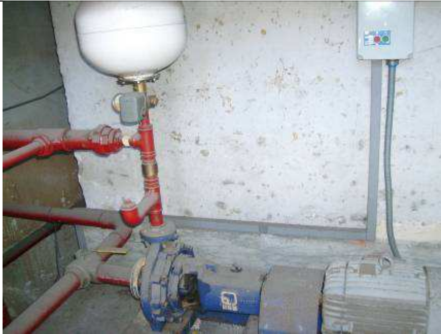
Equipo de presurización para combate de incendio
