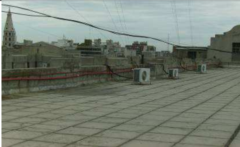
Tubería en PP de interconexión entre los depósitos elevados
