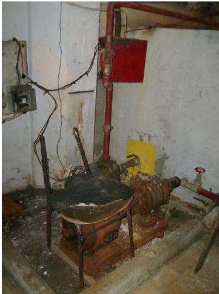
2009 - Instalación de bombeo en el Subsuelo – Tanque Sur
